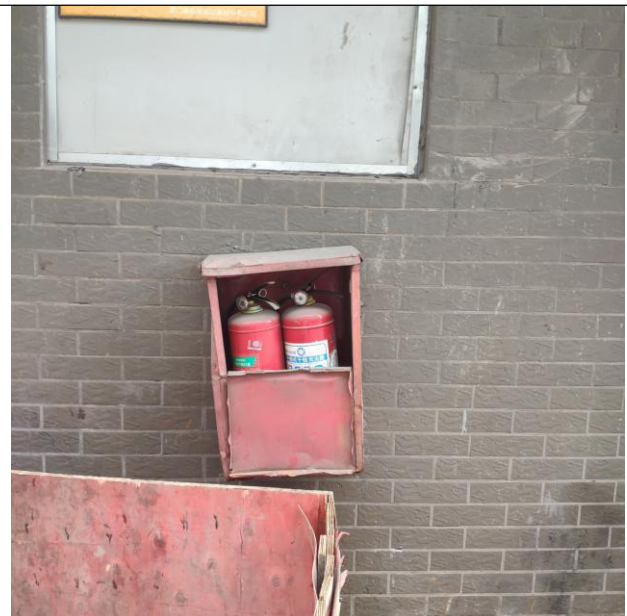
危废间灭火器
