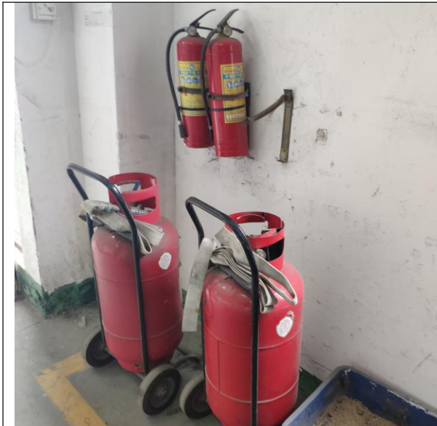
喷漆车间消防沙与灭火器
