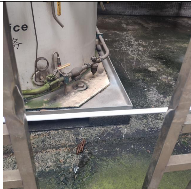
液态气体储罐防泄漏措施
