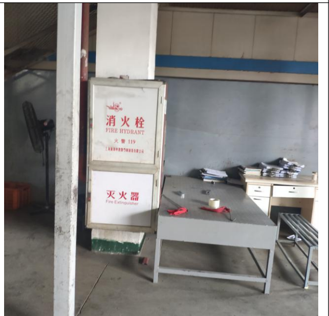
车间内消防栓
