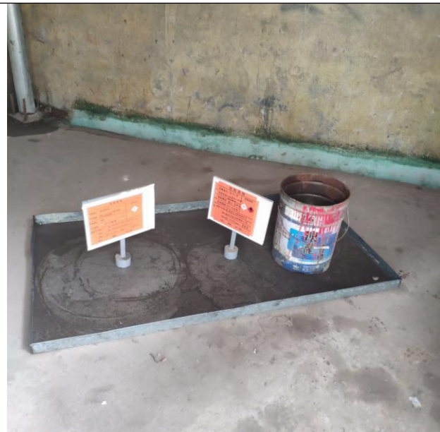
危废间防泄漏措施
